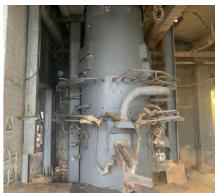
图 18：顶吹熔池熔炼炉
