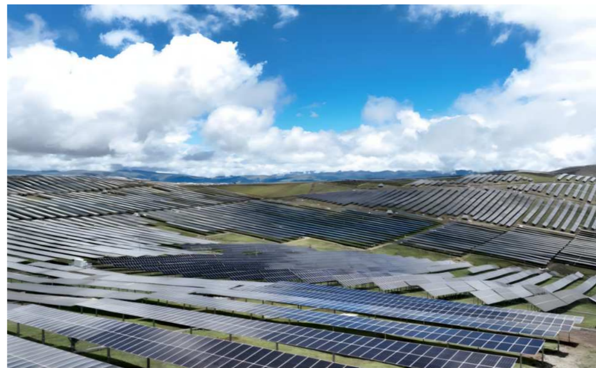
四川省甘孜州的柯拉一期光伏电站
