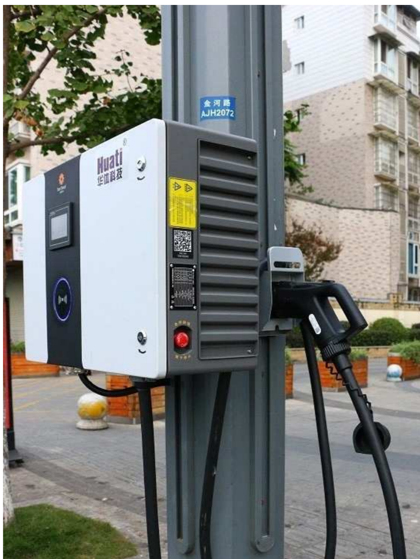
双流金河路“智慧路灯+充电桩”
