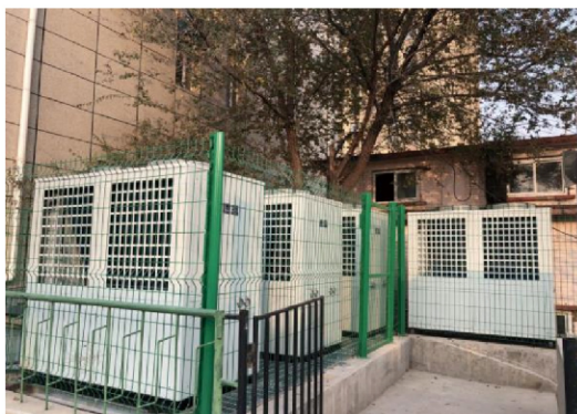
图5-8 德富公司二氧化碳热泵热水机组
